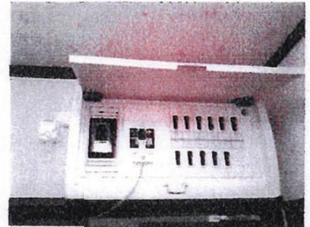
写真1 蓋有り配電盤
