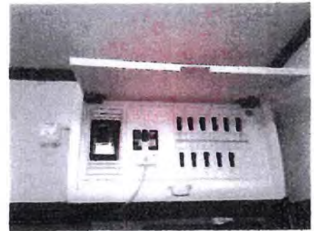
写真1 蓋有り配電盤
