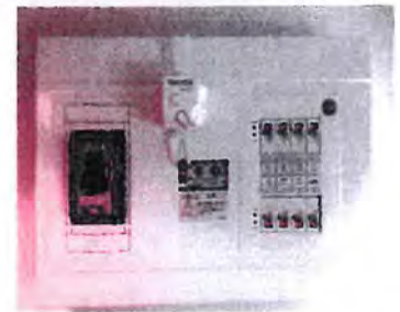
蓋なし配電盤
