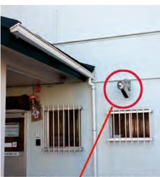
自治会館外壁に設置
