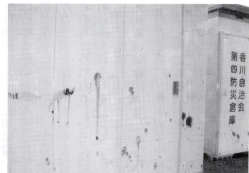
汚れた防災倉庫
